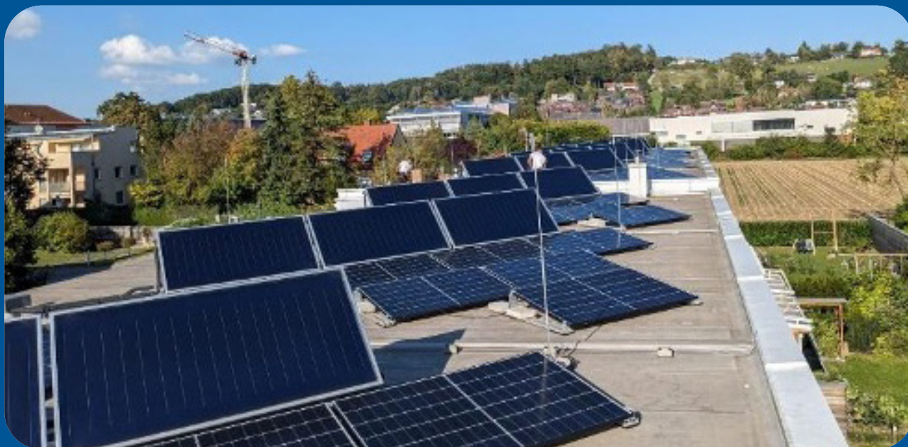
Abbildung: Teil der PV-Anlagen, die zur Energiegemeinschaft gehören. Auch im Bild die vorhandene Solarthermie-Anlage.
